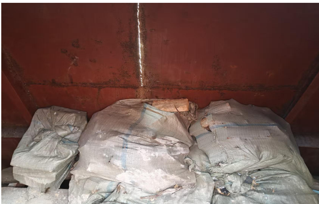
（货舱壁焊缝脱焊，从隔离空舱向货舱方向拍摄）
